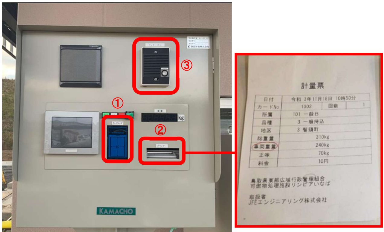
図 3 カードリーダー盤
