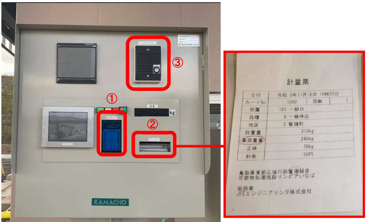
図 3 カードリーダー盤
