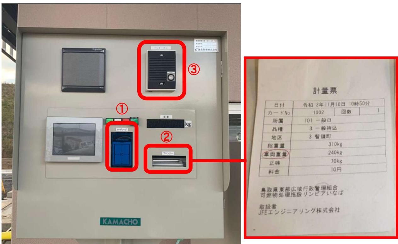
図 9 カードリーダー盤
